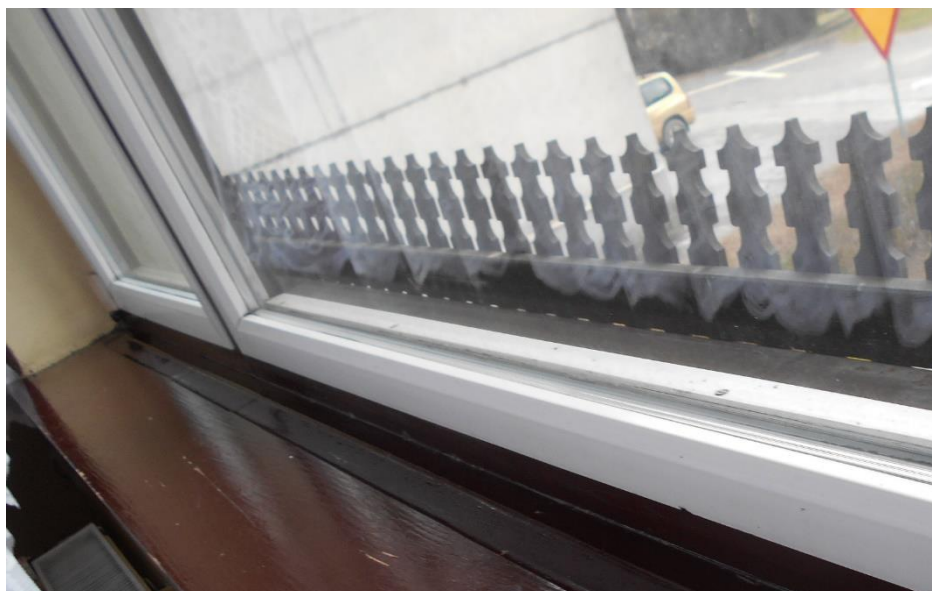
Slika 8: Dotrajano stavbno pohoštvo v nadstropju (PVC 2-sl., U=1'8 \text{ W/m}^2\text{K} )
