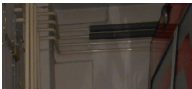
Slika 3: Izolirani cevovodi ogrevalnega sistema
